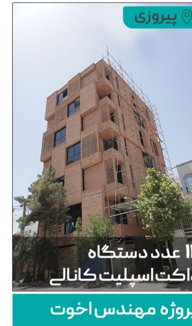
۱۲ عدد دستگاه داکت اسپلیت کانال پروژه مهندس اخوت
